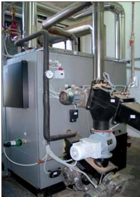
Nova kotlovnica v podjetju Interier d.o.o.
