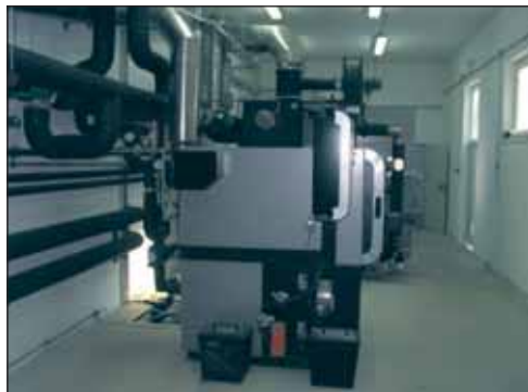
Kotlovnica na lesno biomaso v Lučah
