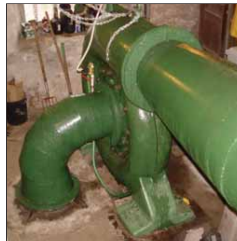
Mala hidroelektrarna po rekonstrukciji - direkten prenos moči na generator (manjše izgube moči, večja zanesljivost delovanja)
