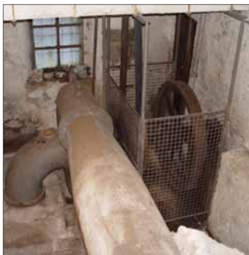
Mala hidroelektrarna pred rekonstrukcijo - zastarel prenos moči preko ploščatega, usnjenelega jermena
