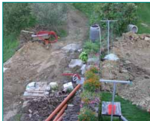
Kanalizacija in kompaktna biološka čistilna naprava.
